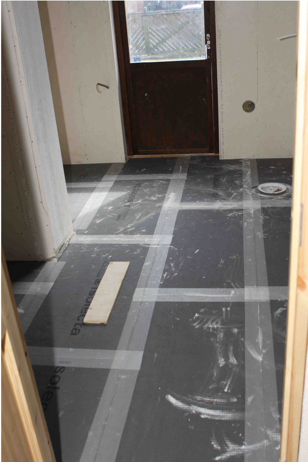
Isolecta-mattor för energieffektivitet vid golvvärme I samband med renovering byttes även VVB.
